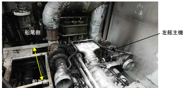
写真3 機関室焼損状況
