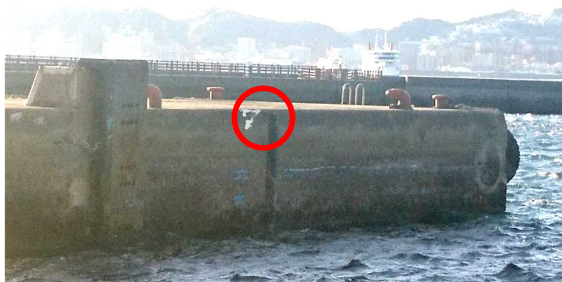
図2 本件バースの損傷状況
