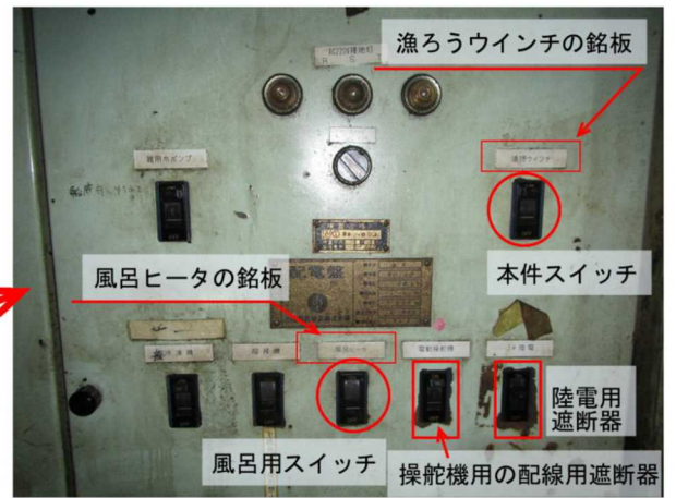
写真10 主配電盤（部分）
