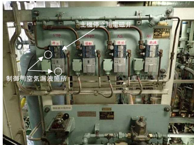
写真2 主機停止用電磁弁
