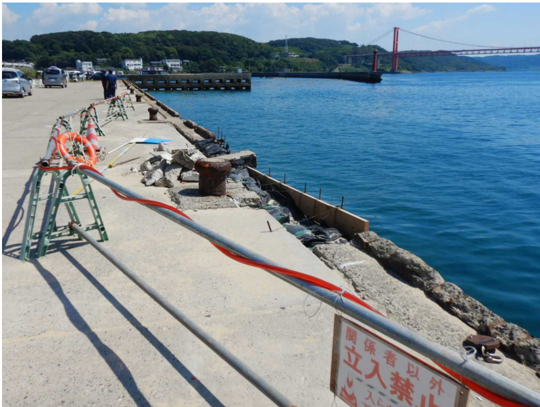
写真2 岸壁の損傷状況
