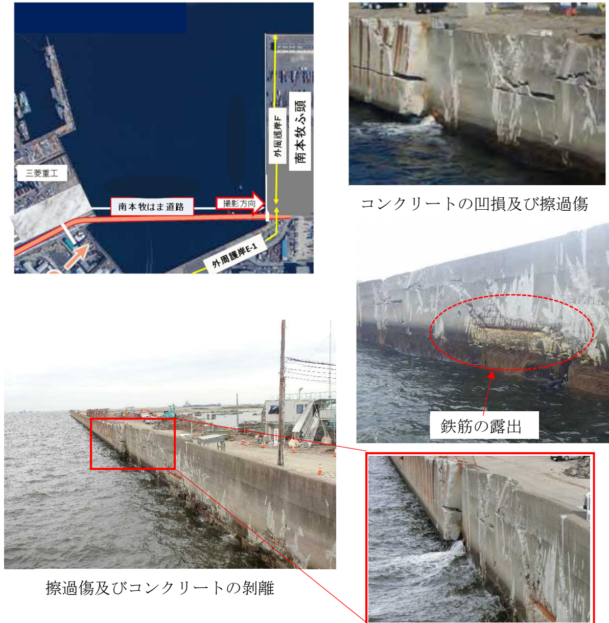
写真3 護岸の損傷状況（抜粋）
