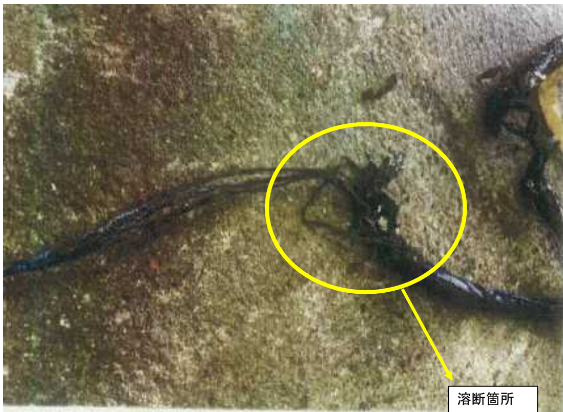
写真3 本件電路の焼損状況
