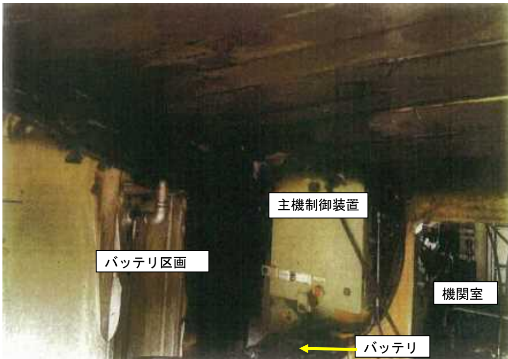
写真2 機関室のバッテリー区画の焼損状況
