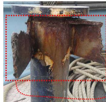
写真8 本件台座の支持部の分離した部分
