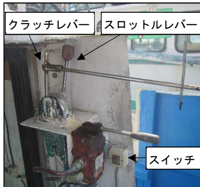
写真6 スイッチ及び主機遠隔操縦装置 (拡大)
