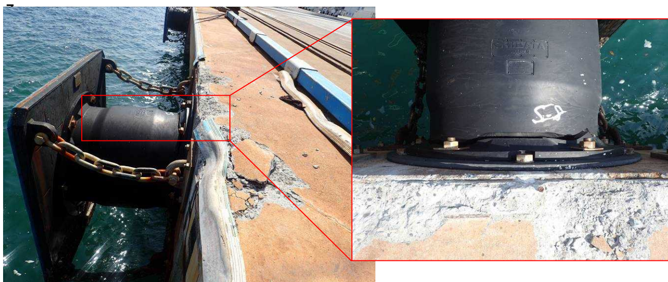
写真2 本件岸壁の損傷状況
