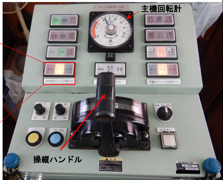
写真1 主機操縦スタンド
