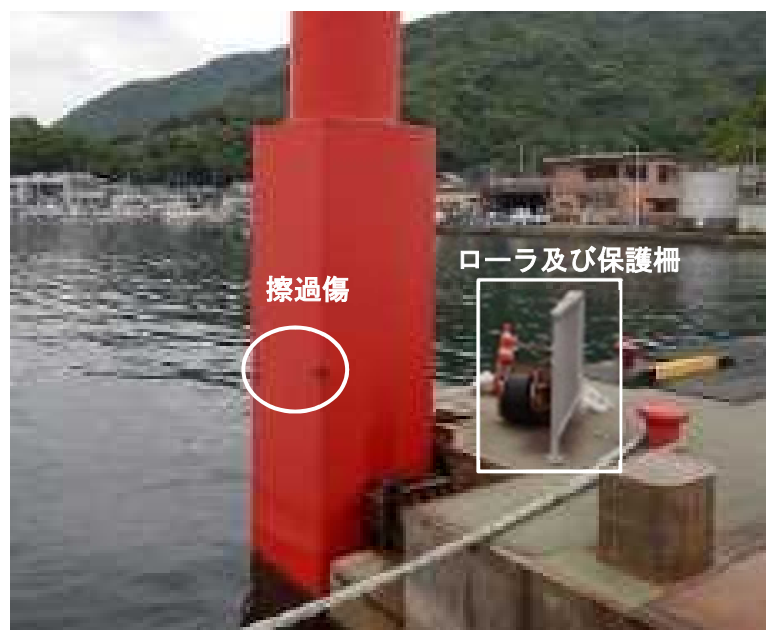
写真6 浮き桟橋損傷箇所
