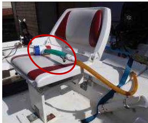
写真1 本件ビルジポンプ
