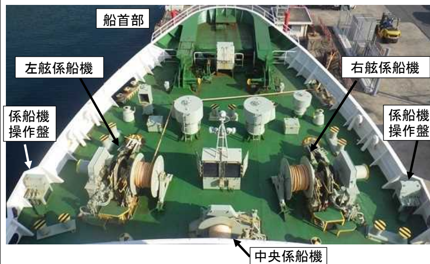
写真 1 船首甲板の係船機及び係船機操作盤
