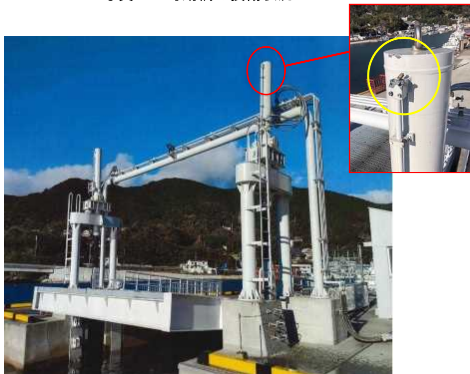
写真4 可動橋の損傷状況
