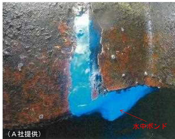
写真5 船首スパッドの架台取付部の亀裂
