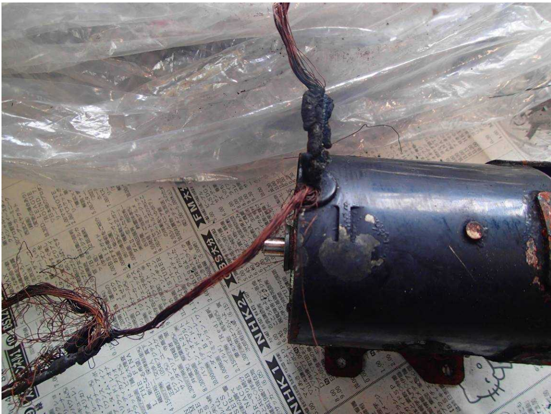
写真3 電動ビルジポンプ用モータの電線の焼損状況
