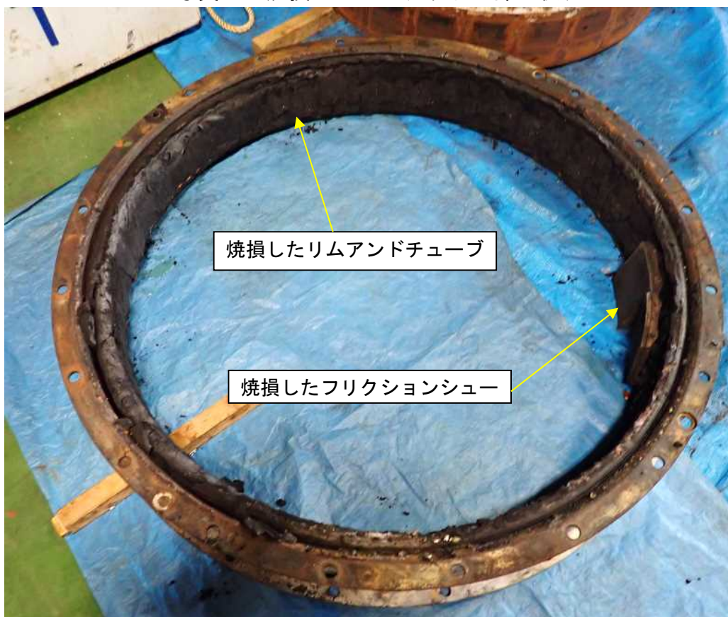
写真3 焼損したエアクラッチ部の状況
