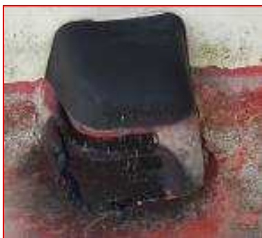
船尾排気管（外板外側）溶損
