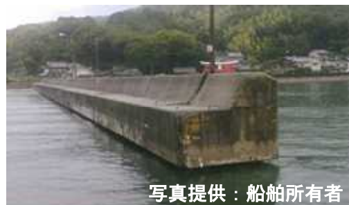
写真4 本件防波堤の先端部
