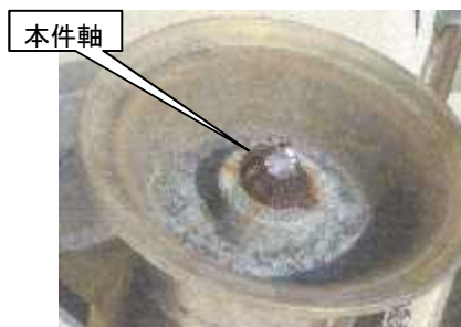
写真6 本件ドラムの状況
