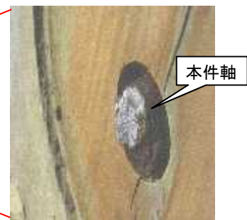
写真5 本件軸の状況
