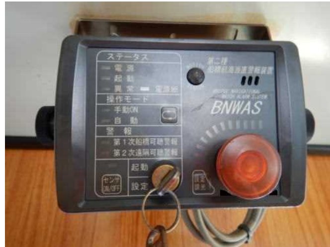
写真2 本件警報装置の操作パネル
