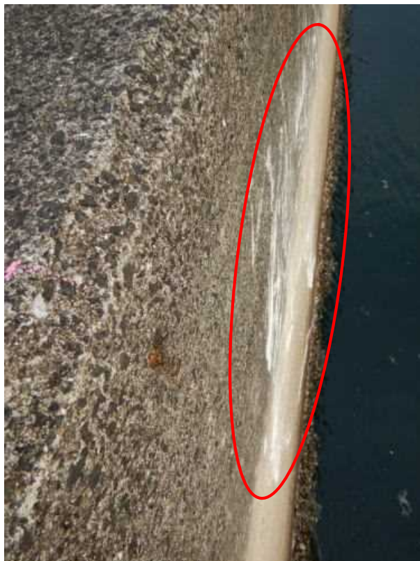
写真1 本件防波堤の擦過傷
