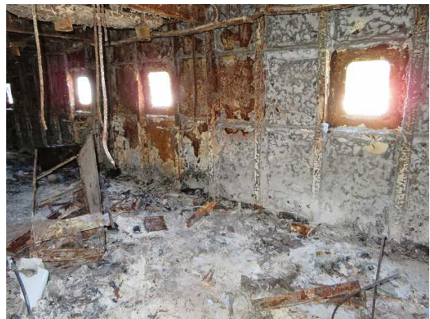
写真2 焼損状況 (3居室同一区画)
