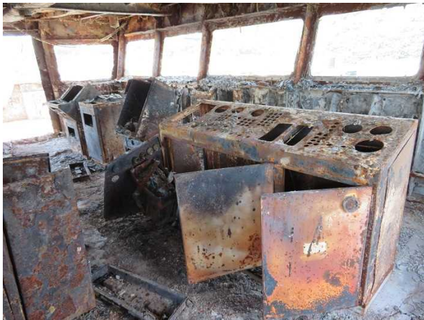
写真3 焼損状況（船橋内）
