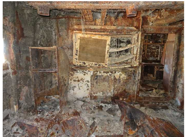
写真4 焼損状況 （船尾楼甲板右舷前方、荷役事務室内）
