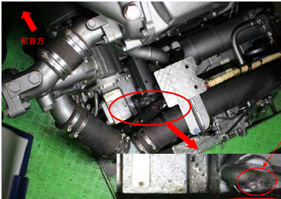
写真2 本件プラス側電線継足し部の焼損状況
