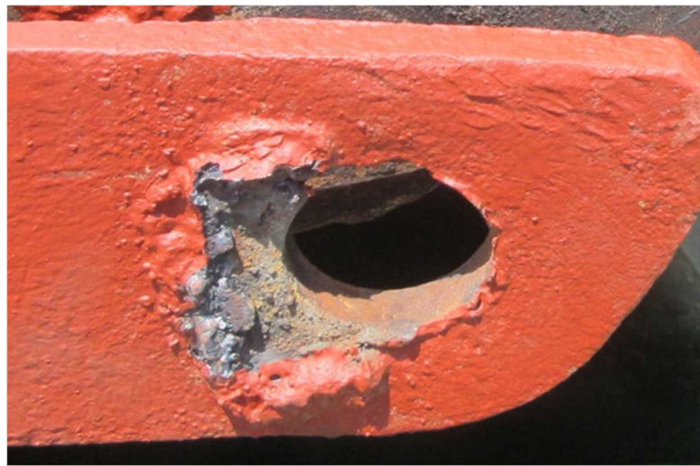
図8 キープレート剥落の跡
