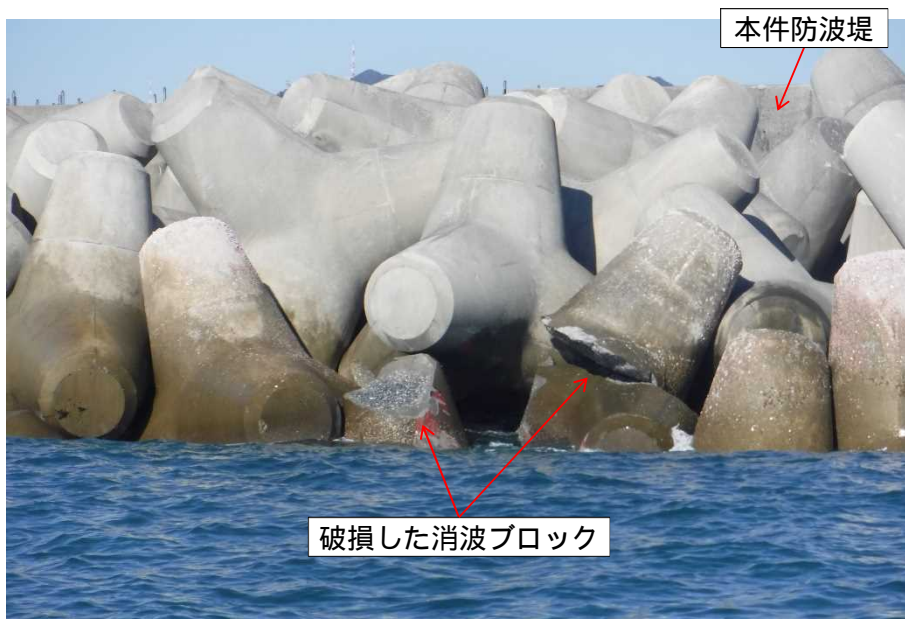
写真3 消波ブロックの損傷状況（四国地方整備局高知港湾・空港整備事務所提供）
