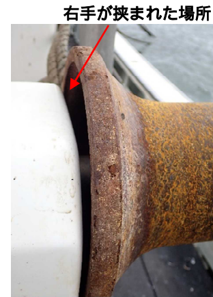
写真2 本件ドラムの状況 (拡大)
