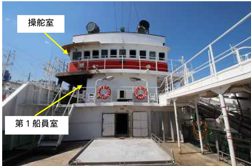
写真1 焼損状況（船首部から望む）
