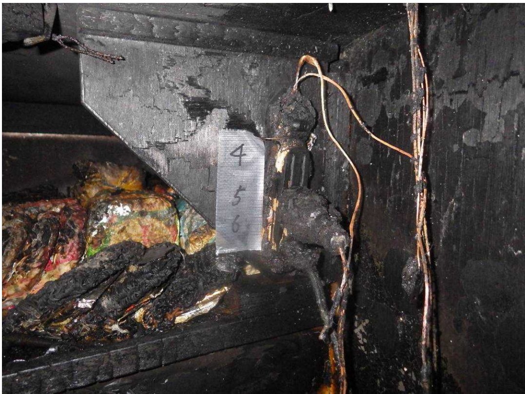
写真4 焼損したテーブルタップ
