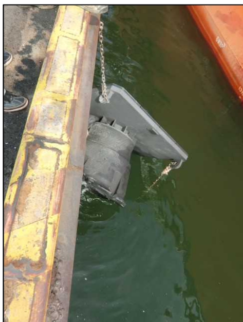
写真2 防舷帯の損傷状況
