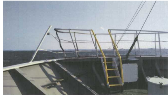
写真2 船首部ハンドレールの曲損
