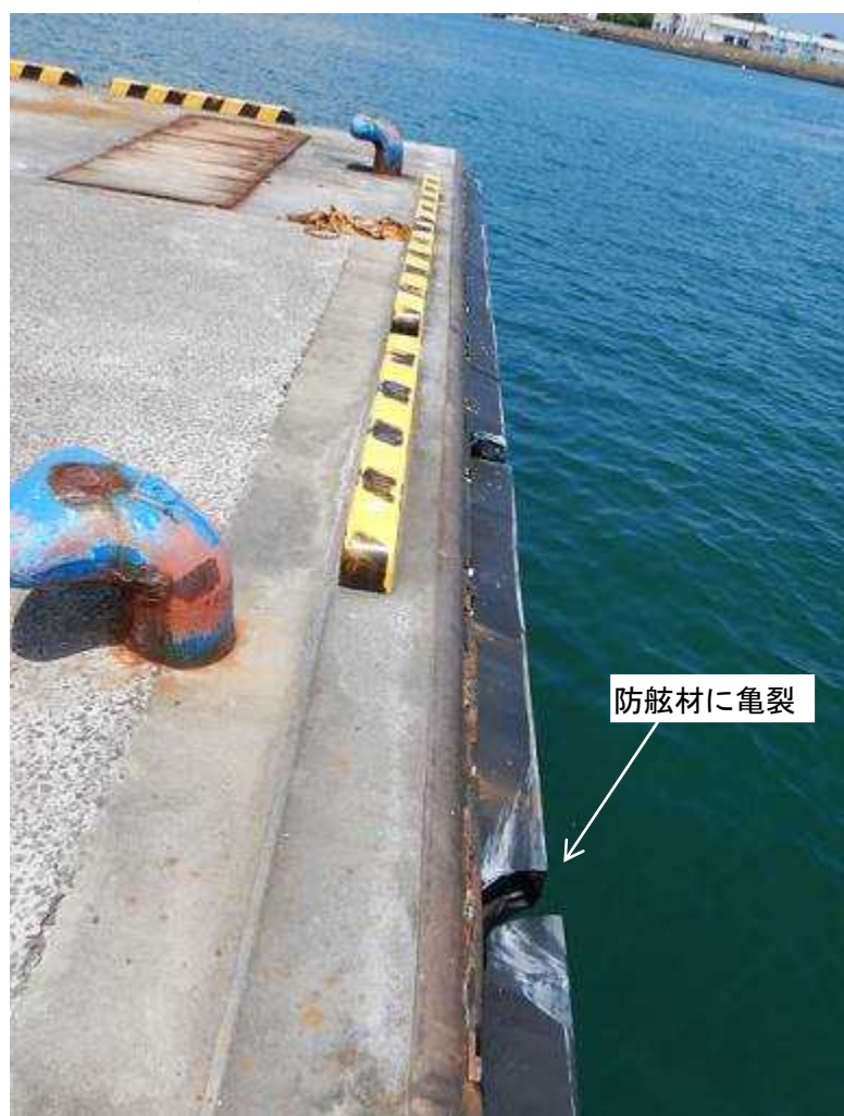
写真2 2号棧橋の損傷状況
