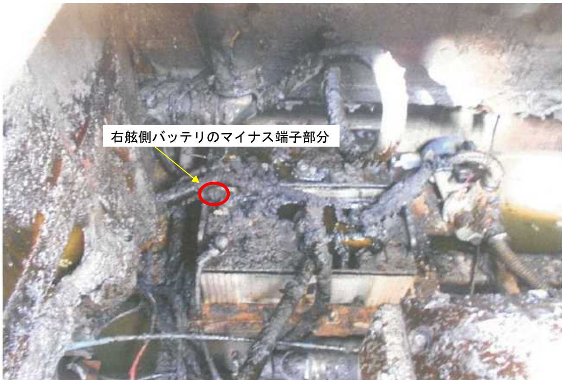
写真2 バッテリー焼損状況（機関室左舷船尾部）
