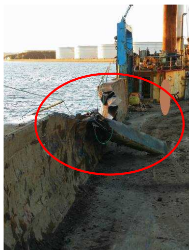
写真4 C船の損傷状況 (1)
