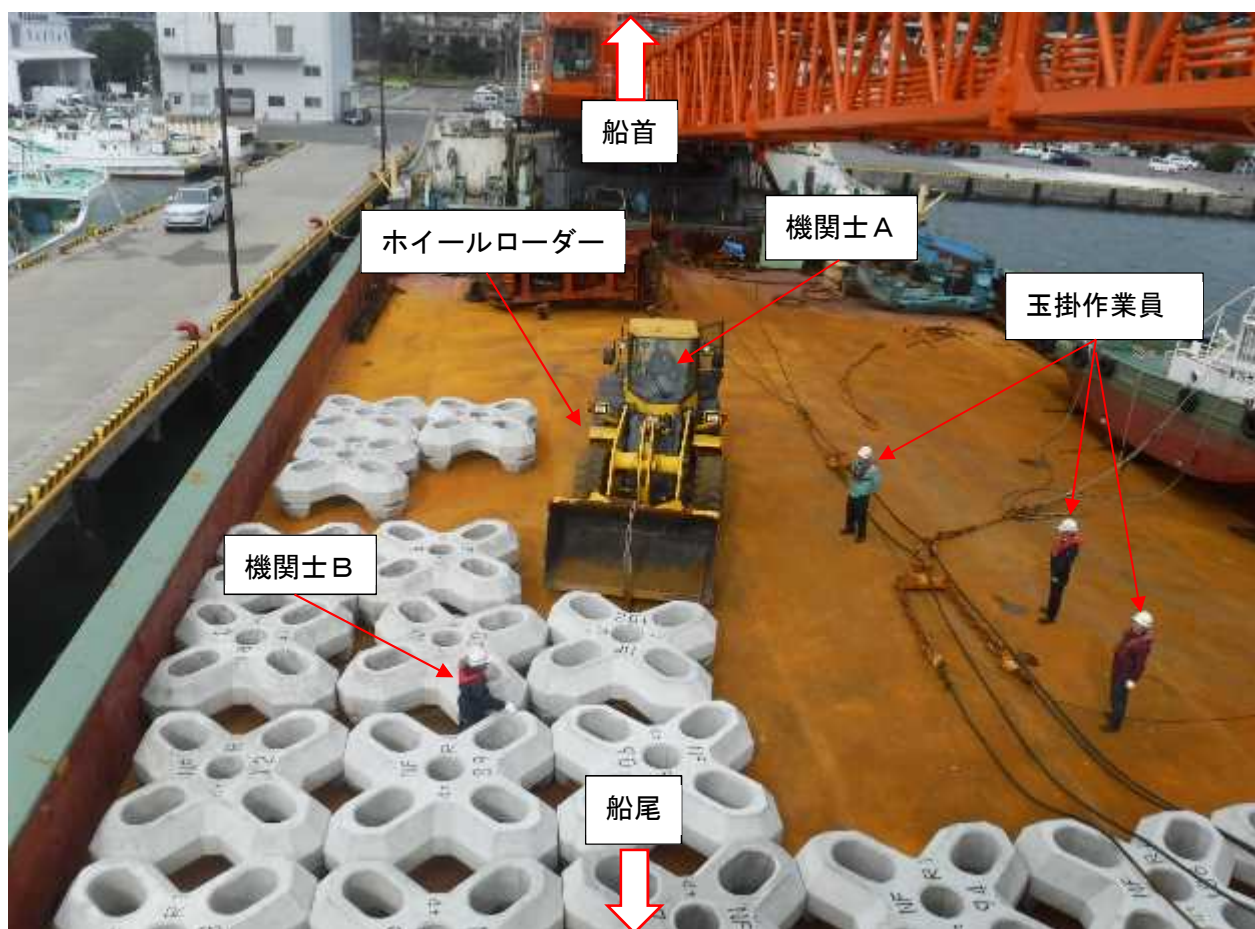
写真2 事故発生状況（再現）
