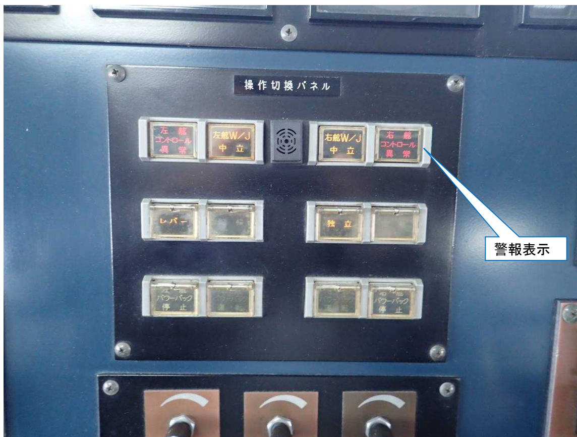
写真7 操作切換パネル
