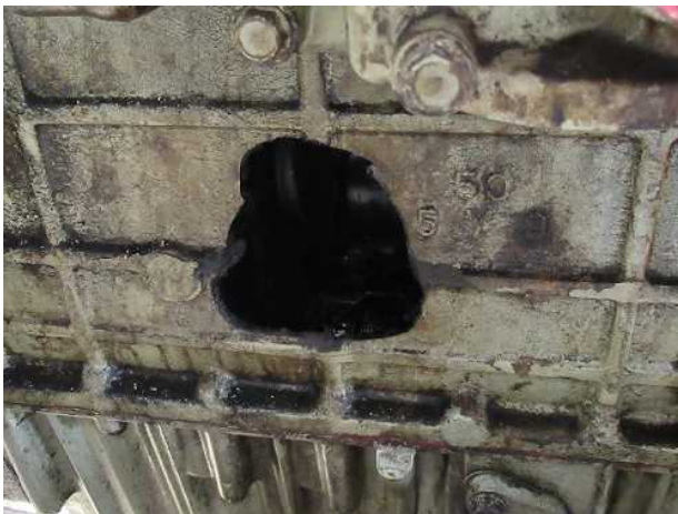
(写真1 / 右舷 / 潤滑油冷却器側)
