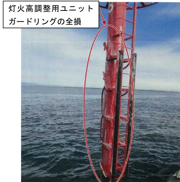
写真4 本件灯標の損傷状況(2)
