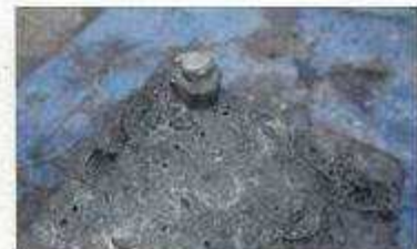
写真10 本件バッテリー (-端子)
