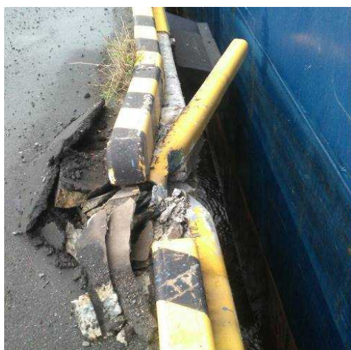
写真2 本件岸壁の損傷状況
