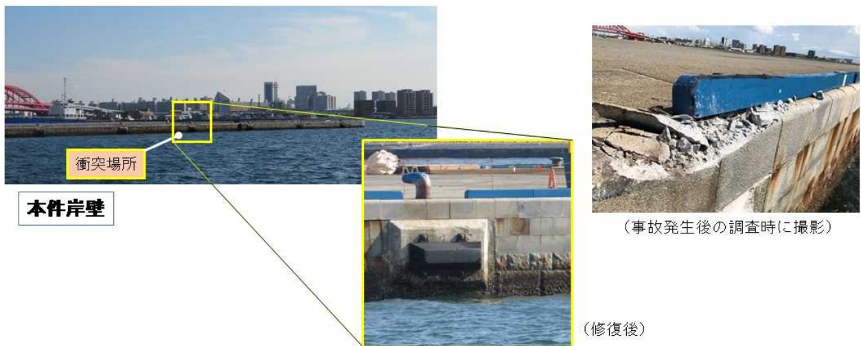
写真2 本件岸壁の損傷状況
