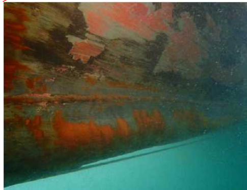
左舷船首部船底外板に凹損を含む擦過傷
