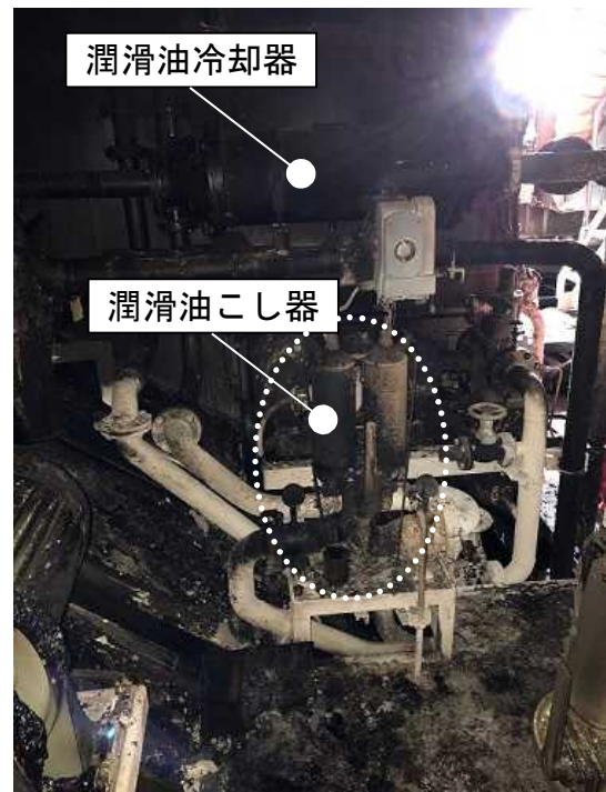
写真2 潤滑油冷却器付近
