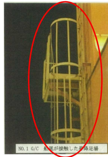
写真2 1号クレーンの損傷状況
