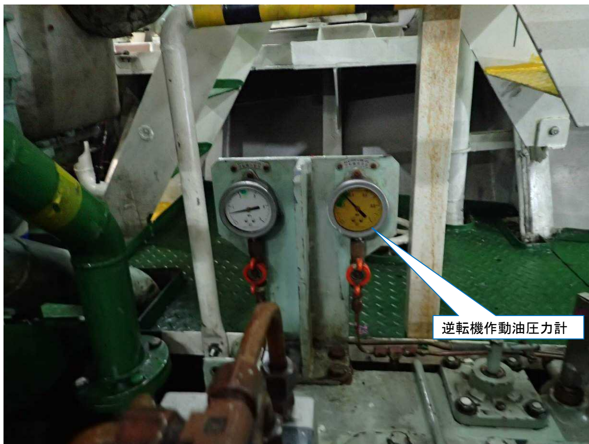
写真6 逆転機作動油圧力計
