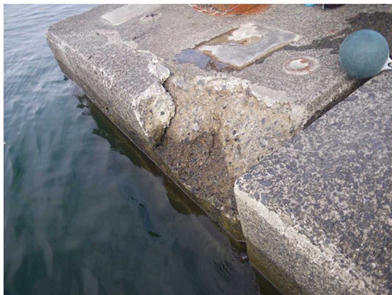
写真4 本件防波堤の損傷状況
