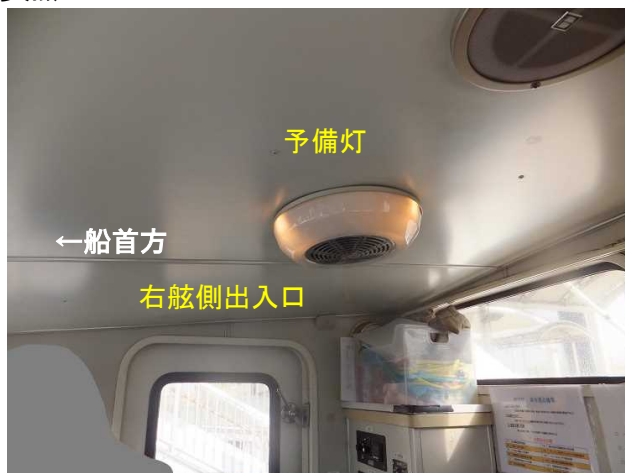
写真2 予備灯(点灯した状態)
