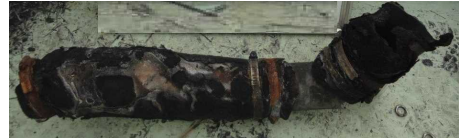
写真4 溶損した排気ゴムホース
