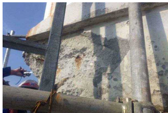
写真4 基礎部分の損傷状況
