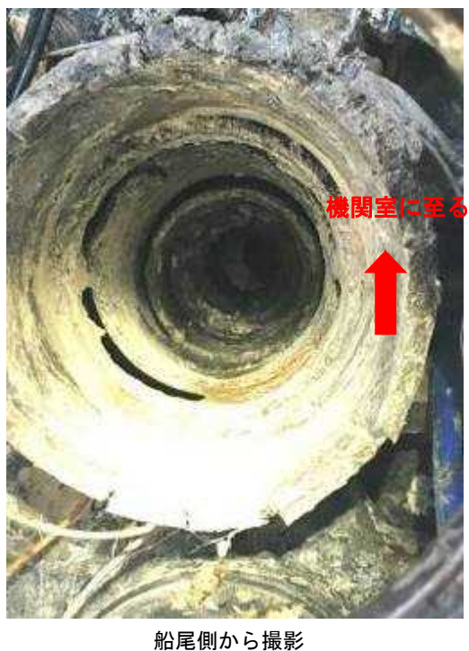
写真4 本件軸受箱内部の破損状況
