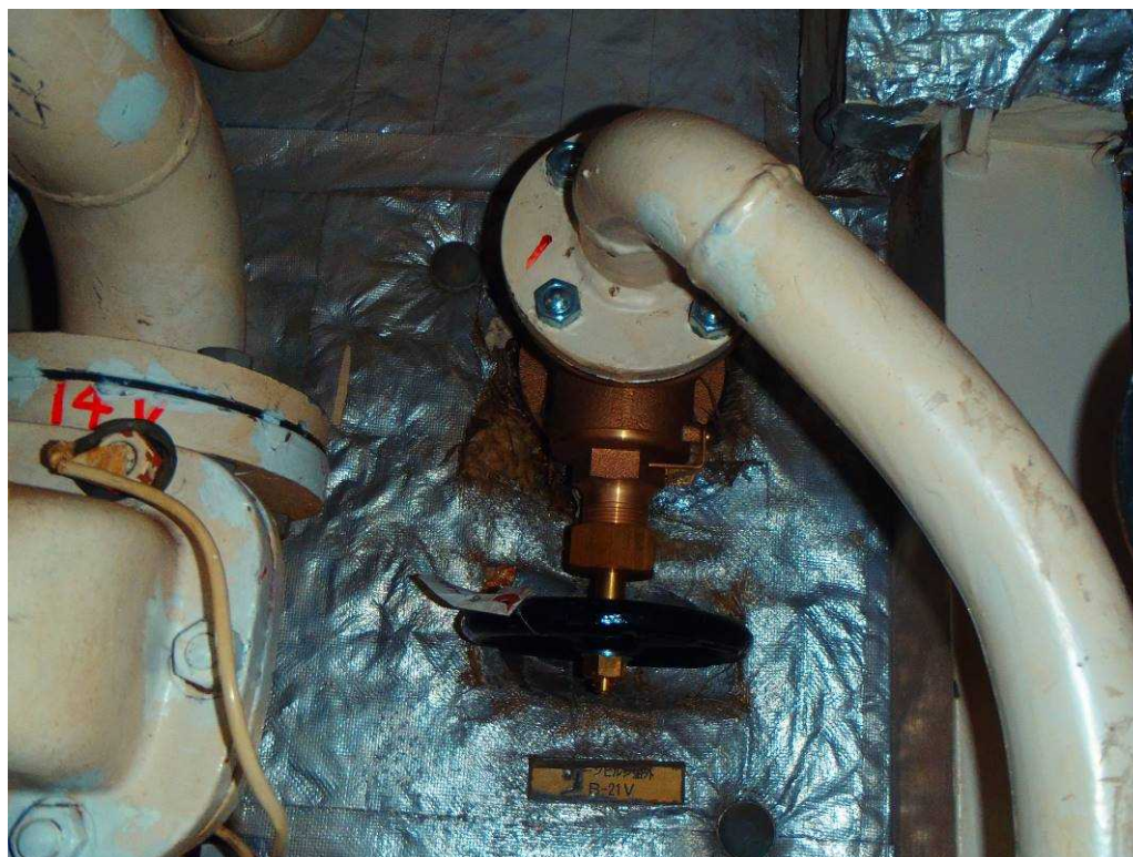
写真5 本件船外弁（新替え後）
